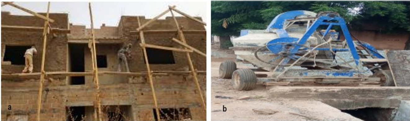
Photo 3: a) Maçons en construction sans mesure de protection ; b) Bétonnière installée aux abords d'un caniveau
